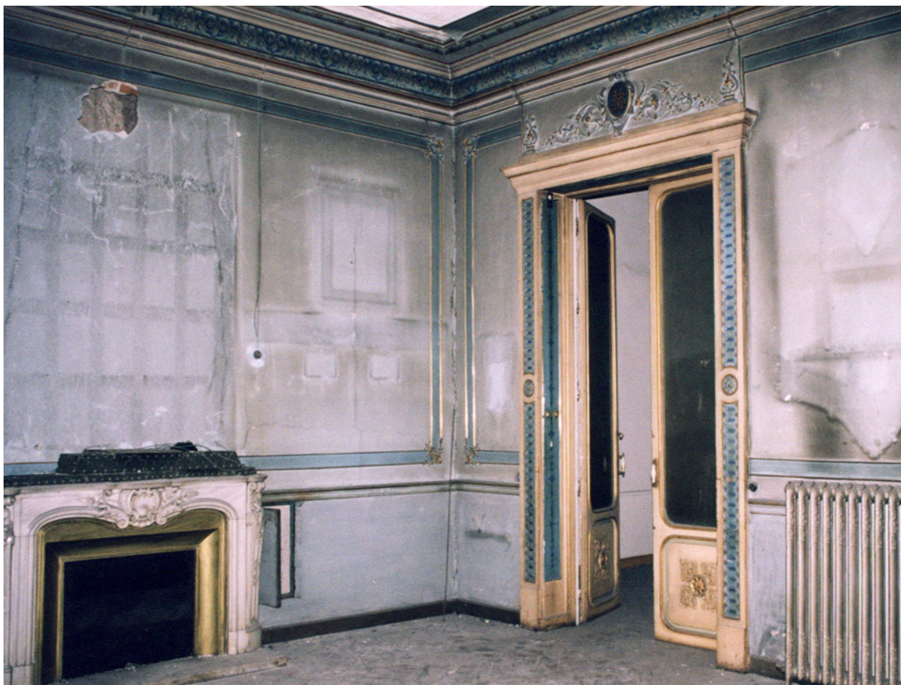
Figura 6. La sala 01 al iniciarse la rehabilitación del edificio. La decoración que presentaba se correspondía con la fase VII: pintura gris/azul sobre anteriores estratos de papel pintado. Fotografía: H. Partners, S.L.
