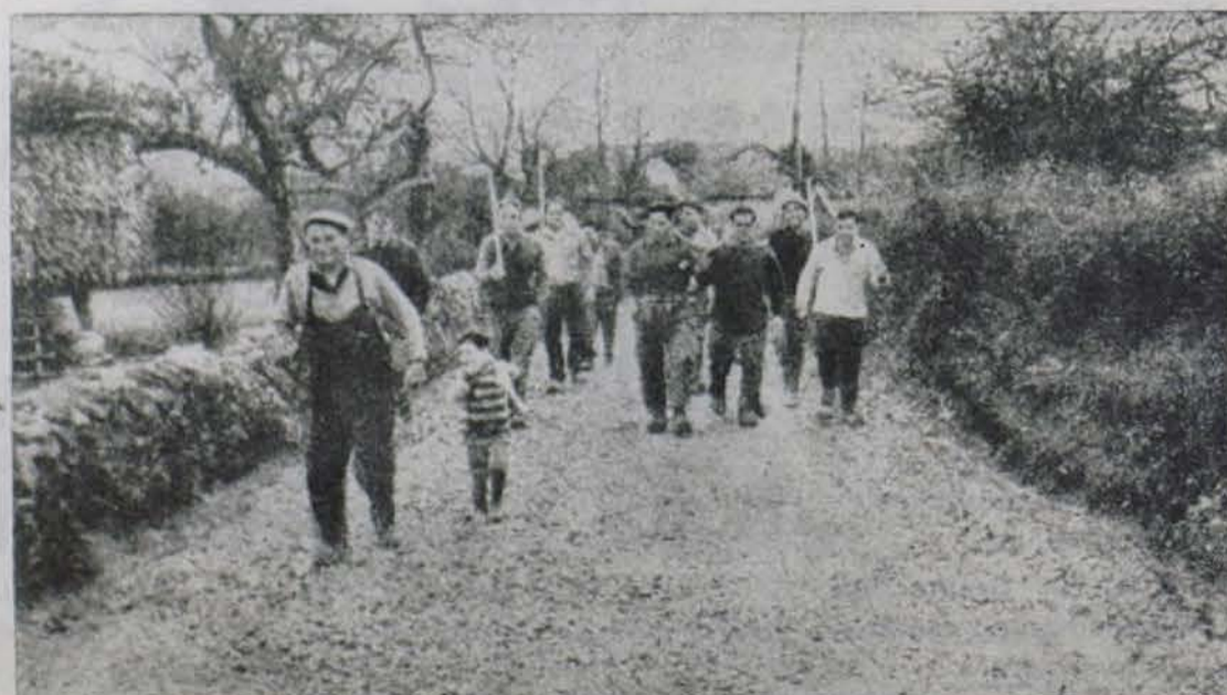
Los vecinos de Ables de Llanera, chicos y grandes, dirigiéndose al trabajo. Han hecho cuestión de amor propia construir la carretera que necesita su pueblo.
