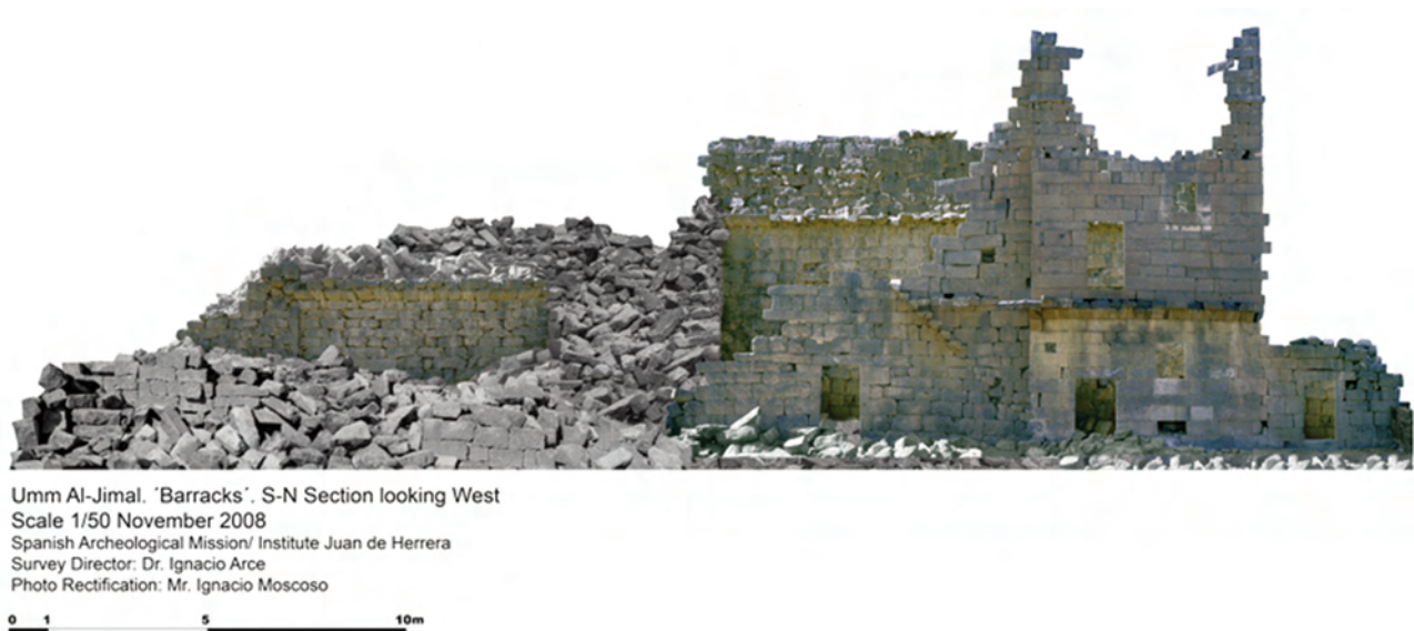
Fig. 5B Umm al Jimal. "Barracks" (Monasterio fortificado). Alzado ortorrectificado. Sección interior S-N mirando hacia el Oeste.
