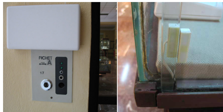
Fig. 56. Mecanismos de seguridad en las instalaciones de los años setenta y ochenta (fot. C. Dávila).
