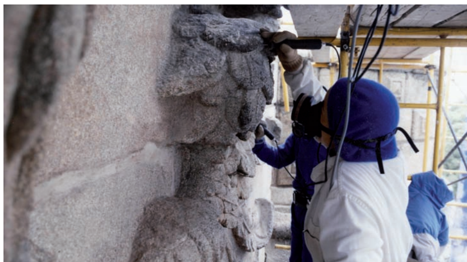
1. Restauración de la Puerta Nueva de Bisagra (Toledo, 1993). Foto: Archivo Personal Concha Cirujano.
