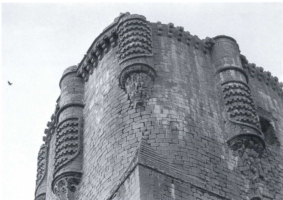
Detalle de la decoración de la Torre del Homenaje del castillo de Belalcázar (Córdoba).
