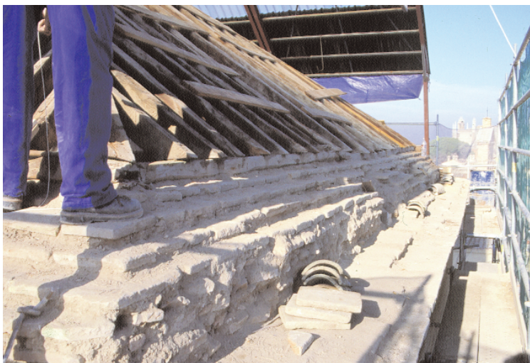
Figura 2: Vista parcial de la restauración de las cubiertas (Fot.: Archivo Fotográfico M. Sefardi)
