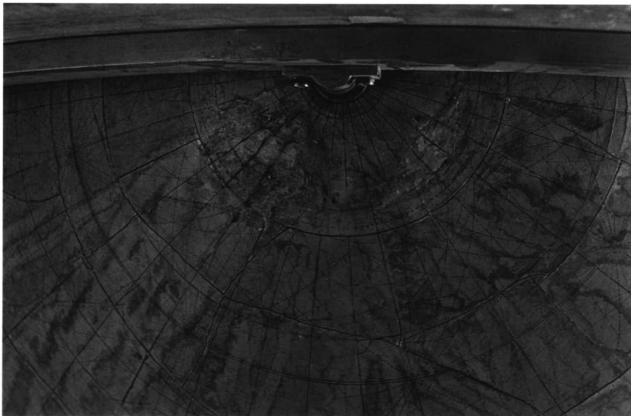
FIGURA 9: DETALLE DEL POLO SUR. PÉRDIDAS DE PAPEL. REPINTES SOBRE EL ESTUCO.
