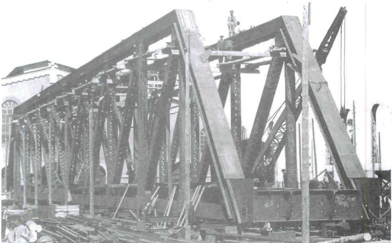
135.—Talleres. Conservación de un gran puente remachado de 70 m. de luz para el ferrocarril Santander Mediterráneo a su paso sobre el río Duero. 1929. Detrás, a la izquierda, el edificio de Talleres. (31-mayo-1929. Foto: León)
