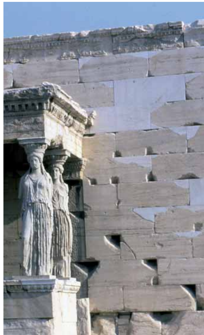
Figura 5. Pérdida de fragmentos en sillares del Erecteión en la Acrópolis de Atenas. Fotografía: Rafael Fort.
