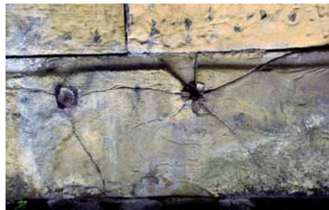
Figura 4. Fisuras por oxidación de elementos metálicos en areniscas de San Sebastián. Fotografía: Rafael Fort.
