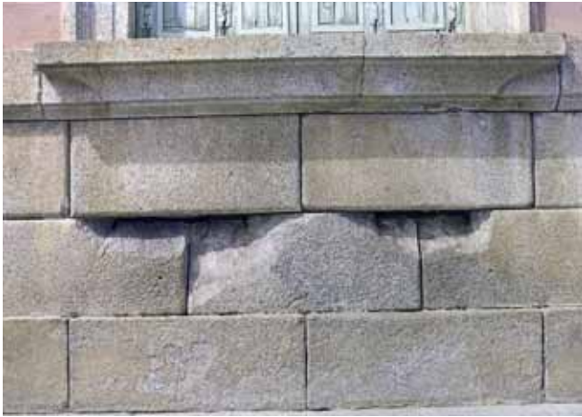
Figura 6. Deterioro por grapas de hierro en el Palacio de Riofrío (Segovia). Fotografía: Rafael Fort.
