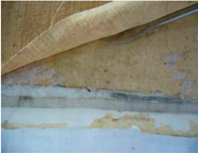
Fig. 21 Desprendimiento de la tela.
