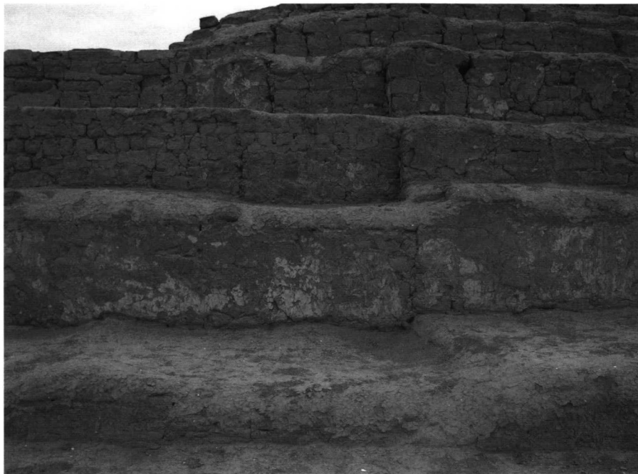
FIGURA 4: ESTADO ACTUAL DE LOS MURALES
