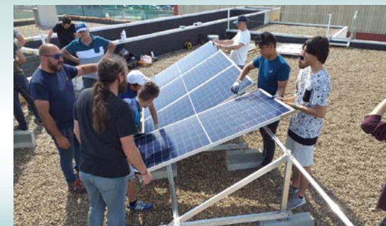
Instalación fotovoltaica diseñada y construida por el alumnado
