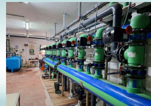
Visita de profesoras a las instalaciones hidráulicas y de gestión del agua del complejo termal Poseidon de Nápoles
